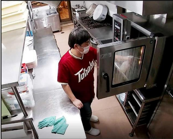
8 スチコンの掃除 スチームコンベクションを衛生的に保つことも重要。 見えにくい箇所でも、洗浄液をどこに置くか、また設備配 管の納まり等についても配慮する。
