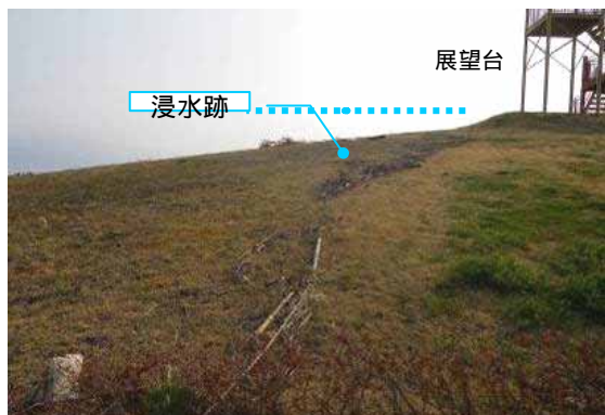
写真-7 築山の浸水跡
